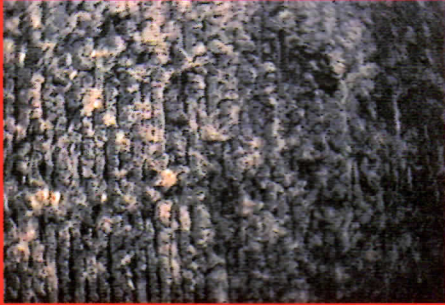
設置場所 物品販売店舗 使用年数 3年 撮影面 熱交換面 機種 4方向天井埋込型
