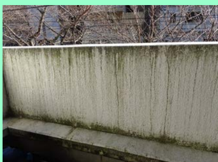
【施工前】 雨垂れの跡が目立ちます。
