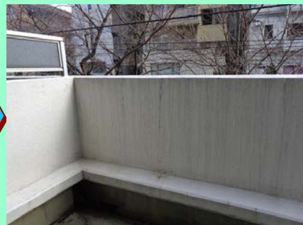
【施工完了】 洗浄後に、塗装工事・防水工事の実施となります。
